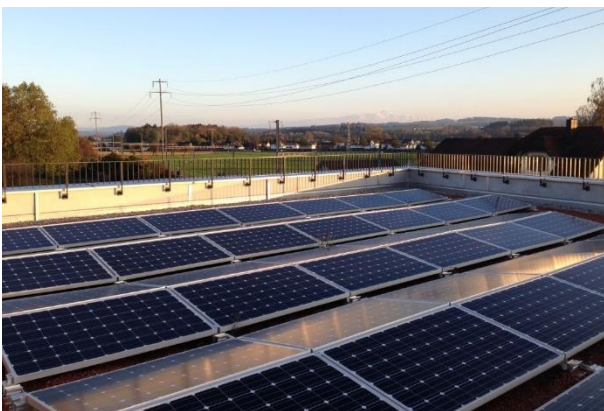
Photovoltaik-Anlage auf dem Dach
