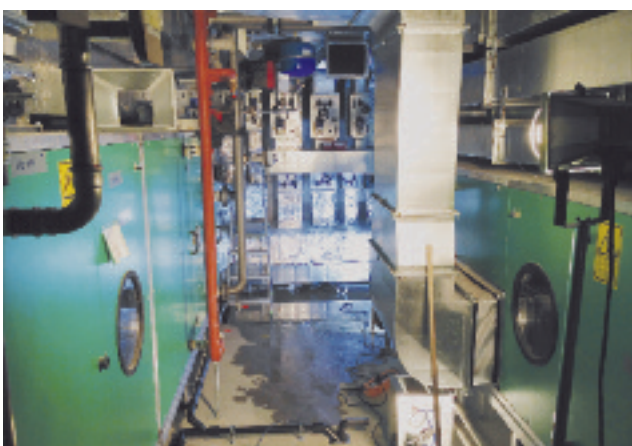
Eindruckliche Lüftungsanlage im UG
